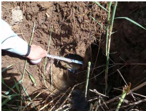
Рисунок 2.4.5: Функционирующее водовыпускное отверстие
