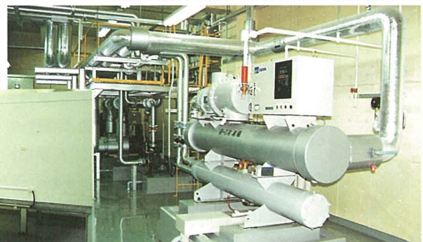
▼風洞付帯設備（冷凍機・温度調整装置・除湿装置など）
