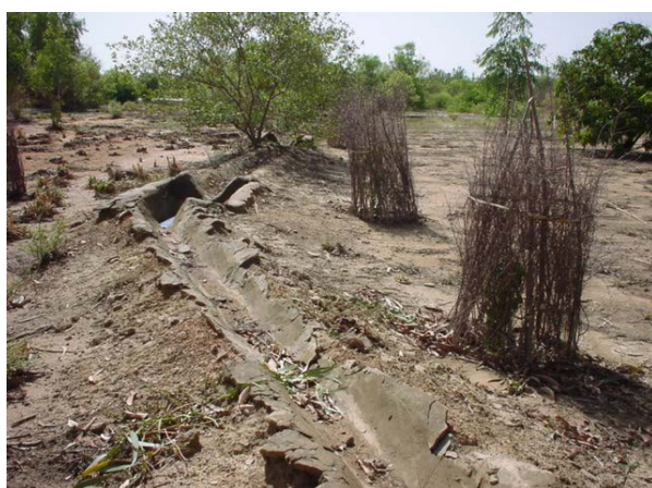
破損により使用不可能となった、[日乾し煉瓦＋モルタルライニング水路]
