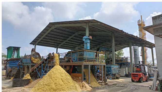
図3 マレーシアジョホール州クルアンにある実証設備。廃液などは糖質回収、バイオガス製造、液肥化を行い、多種多様(カスケード)な利用を行うゼロエミ型プロセスである。
